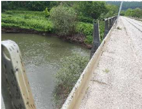
Слика 12.30 – Недостатак сегмента заштитне ограде на мосту
