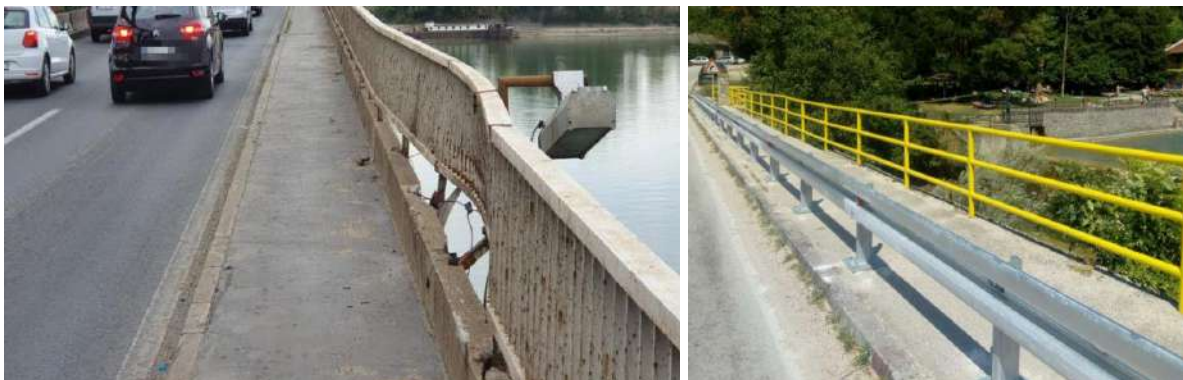
Слика 11.47 – Недостатак еластичне заштитне ограде и оштећена пешачка ограда (лево) и пример заштитних ограда на мосту (десно)
