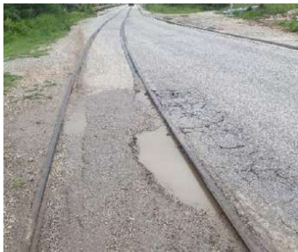
Слика 12.26 – Оштећења коловоза на месту контакта са пругом
